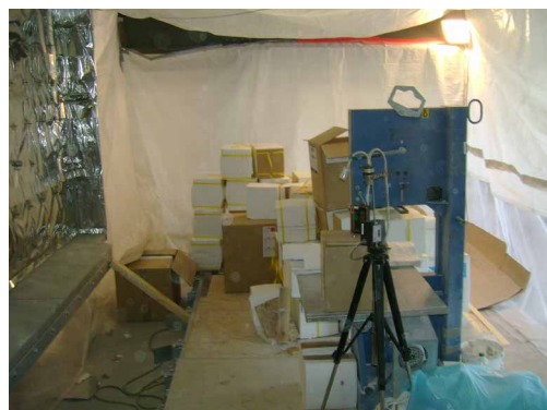
Abb. 1: Geschlossener Arbeitsbereich mit Filtersystem
